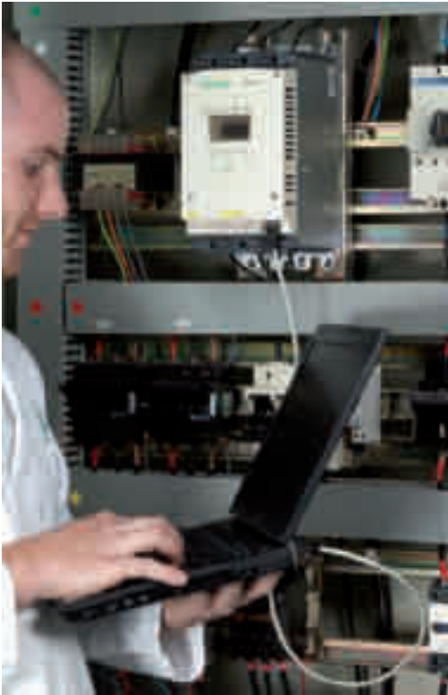
Inbetriebnahme des Sanftanlassers ATS 22 mit der Software SoMove lite
