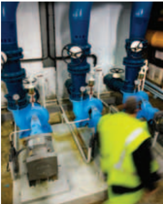
Anwendungsbereich mechanische Aktoren: Pumpen
