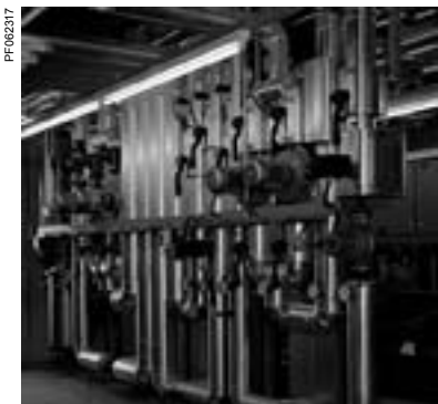
Steuerung einer Pumpenstation mit ATV 12 (▲)
